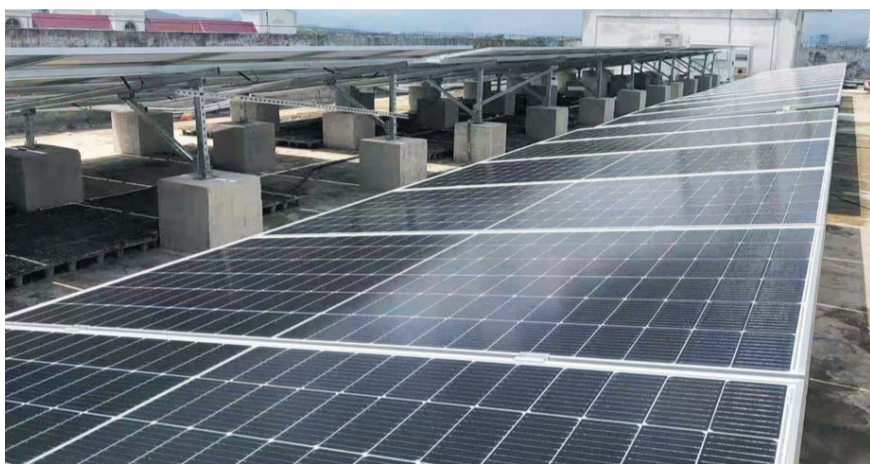
海南第一笔整县屋顶分布式光伏发电项目贷款落地。兴业银行海口分行供图
