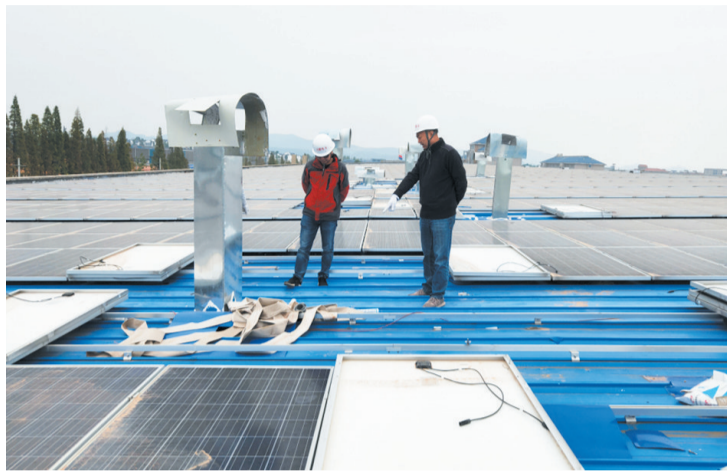
天汇能源在江西对省外光伏项目整改和技改工作进行检查指导。 天汇能源供图
